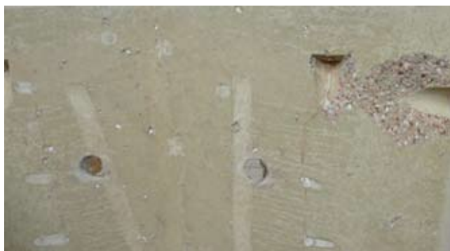
8. ábra. A tűzkárosult szerkezet
