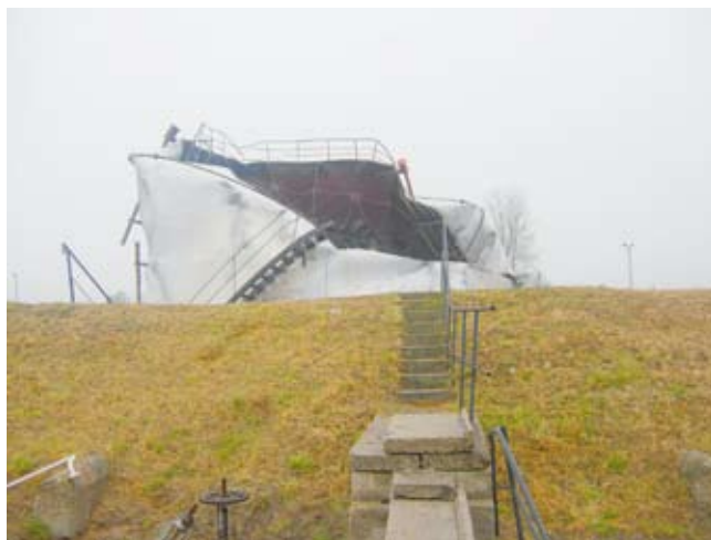
Komárom – súlyosan megrongálódott tartály
