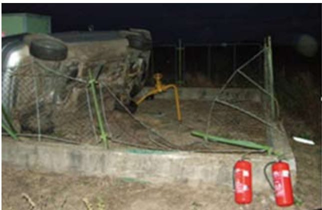
Közlekedési baleset miatt megrongálódott fogadó állomás
