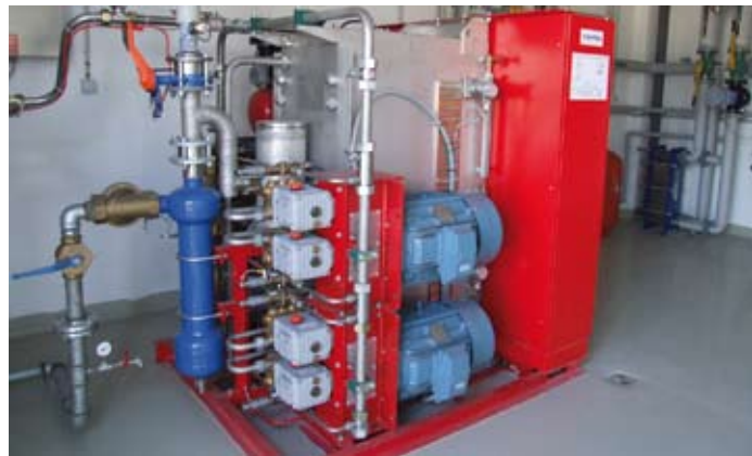
Beépített tűzoltó berendezés
