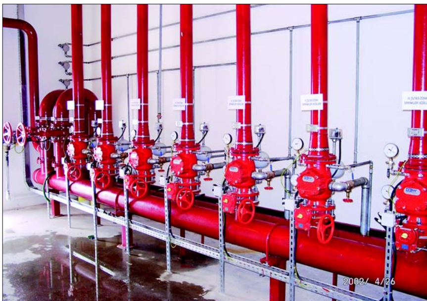
Raktárak, üzemek, irodák sprinkler védelme
