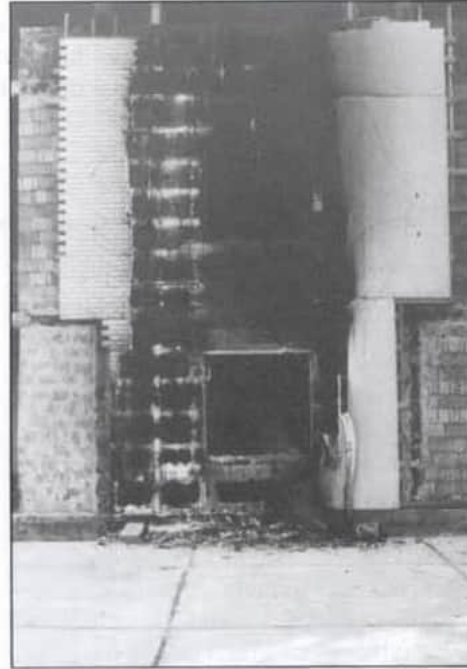
A polipropilén burkolat alsó szinti és oldalirányú károsodása is teljes
