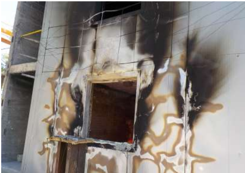
A tűzhatás képe kirajzolódott a paneleken – tovább nem terjedt
