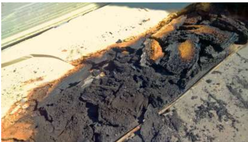
A közvetlen tűztér melletti panel IPN hőszigetelése, égett, szenesedett
