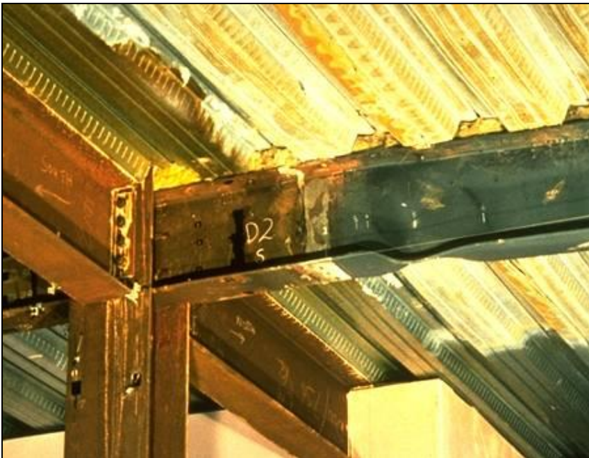
5. ábra Övlemez horpadása a befogott tartóban
