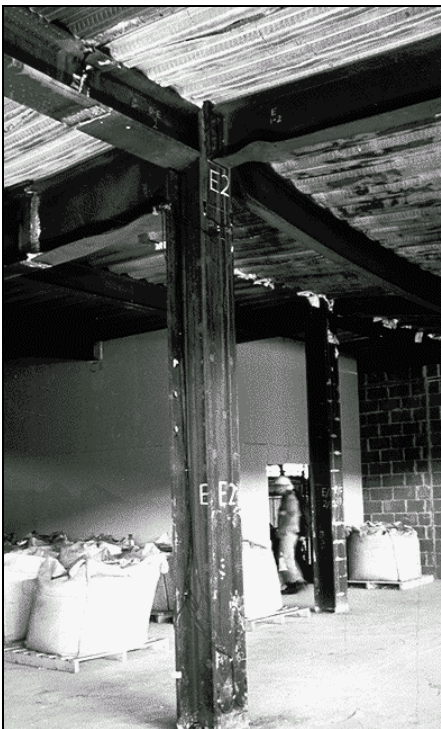
10. ábra A szerkezet a tesztet követően
