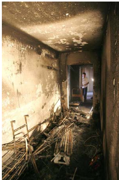
2. ábra: Kiégett menekülési útvonal – 15 lakót kellett kimenteni (forrás: BM OKF)
