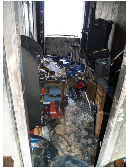
13 sz. kép. A VII. emeleti lakás loggiájának és félszobájának képe a lakás felől (fotó: Takács Lajos)
