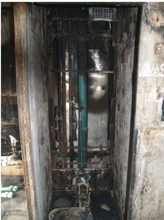
1 sz. kép. A WC helyiség képe a tűzkeletkezés helyén, a VI. emeleten. Jól látható, hogy az akna
