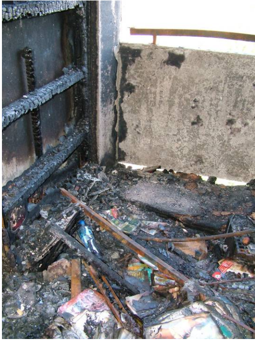
14 sz. kép. A VII. emeleti lakás loggiája. Jól látható a bal oldalon a loggia oldalsó burkolatának égett faváza, továbbá a mellvédfal és a padlóburkolat közötti 10 cm hézag (fotó: Miskolci Tűzoltóság)
