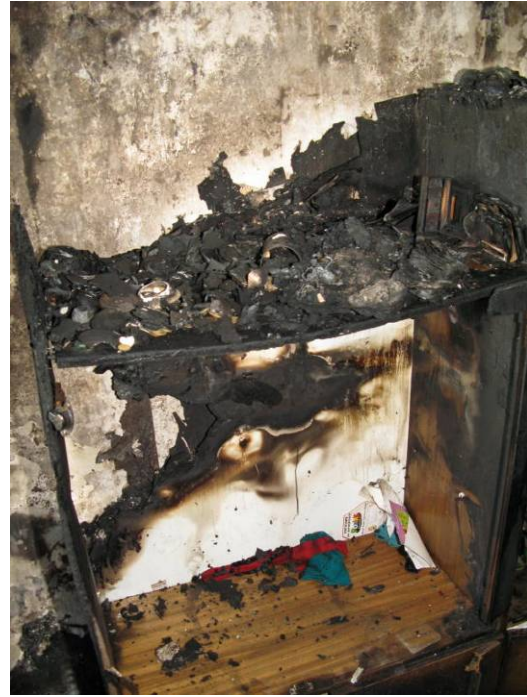
15 sz. kép. Jellegzetes károsodás a VII. emeleti lakásban: az égésnyomok a loggia felől emelkednek, ami bizonyítja, hogy a tűzterjedés a loggia felől következett be (fotó: Király András)
