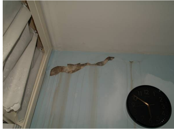
23 sz. kép. Oltóvíznyomok a tűzkeletkezés alatti, V. emeleti lakásban (fotó: Takács Lajos)
