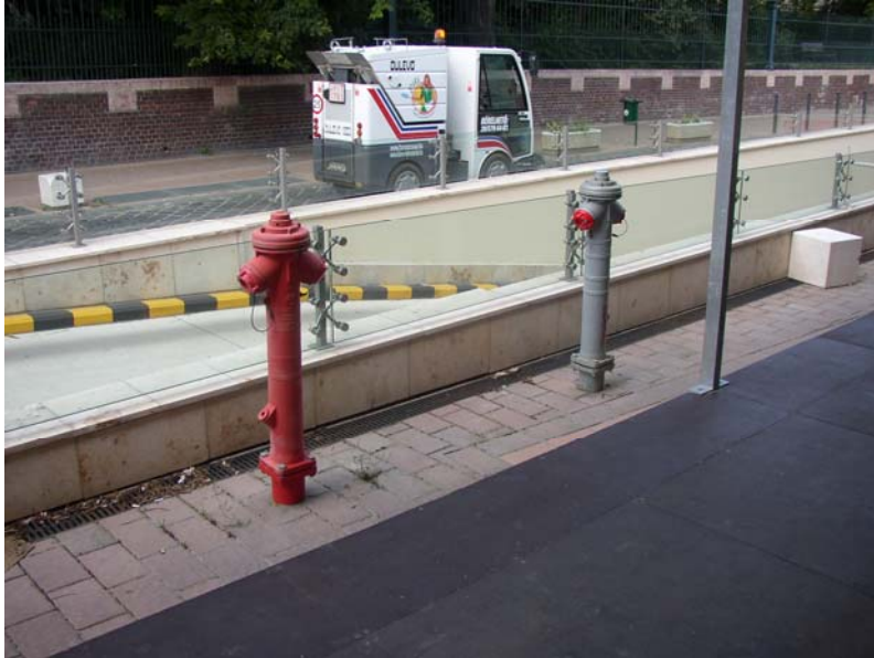
7. sz. kép: Tűzcsap és száraz leszálló vezeték (saját forrás)
