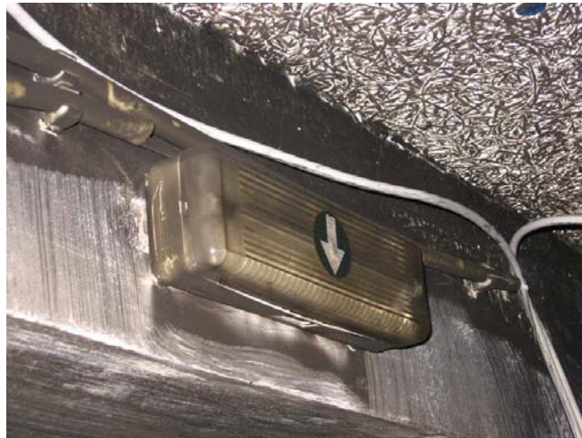
5. sz. kép: Elektromos vezetékek (saját forrás)
