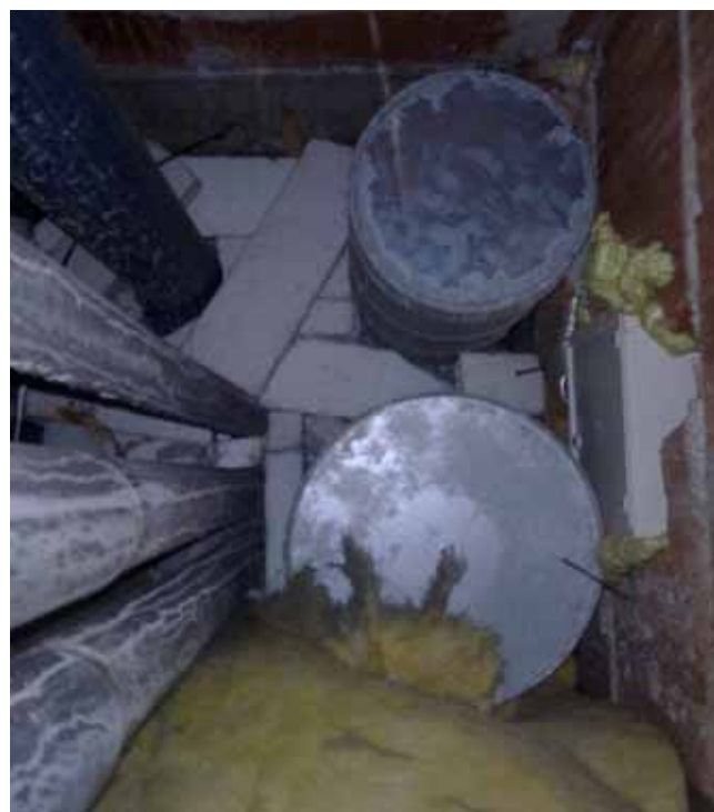
SZERELŐAKNA BELSEJE EGY KÖZELMÚLTBAN ÉPÍTETT, KÖZÉPMAGAS LAKÓÉPÜLETBEN
