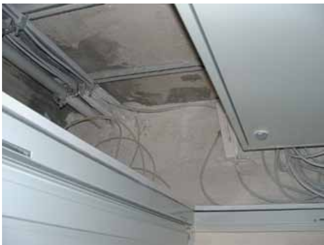
MEGFELELŐEN KIALAKÍTOTT VILLAMOS SZERELŐAKNA
