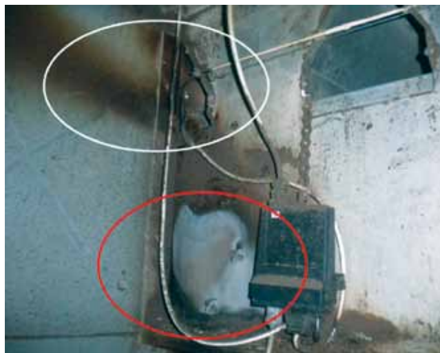
TŰZGÓC (PIROSSAL JELÖLVE): IZZOTT A LEMEZ; LÉG- CSATORNA (FEHÉR JELZÉS): A KICSAPÓ LÁNG ELÉGET- TE A KÁBELT, BEKORMOZVA AZ OLDALFALAT
