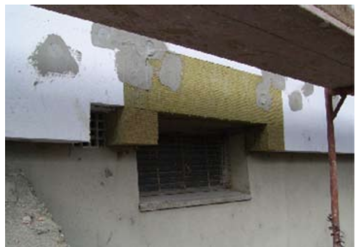
5 sz. kép. Szakszerűtlenül kivitelezett vegyes rendszerű hőszigetelő homlokzati bevonatrendszer
