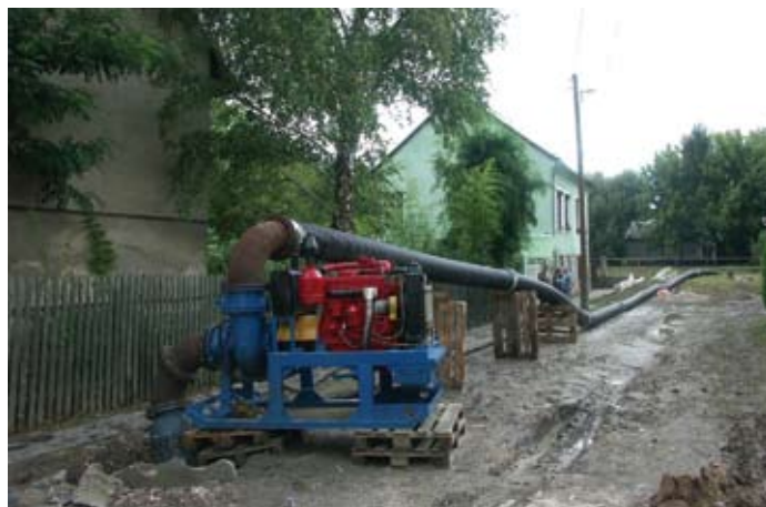
Átemelő szivattyú – eredményes védekezés
