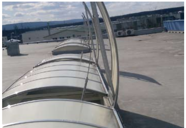
Sáv-felülvilágító pneumatikus munkahengeres nyílászárnyal, RWA állapot
