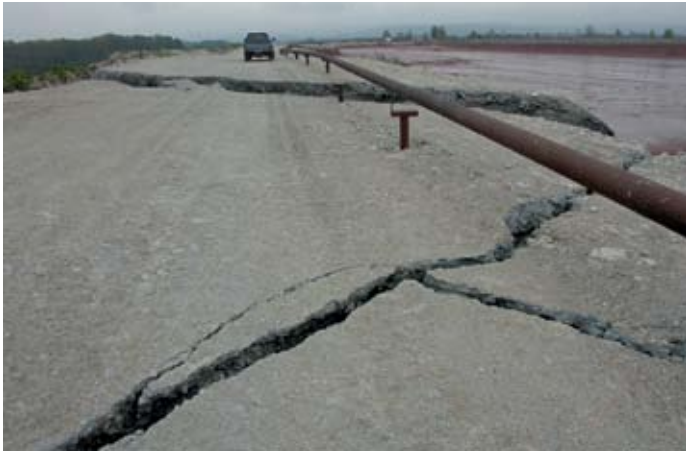
Repedések a gáton
