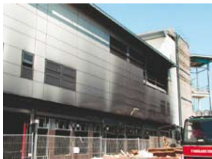
Az épület külső homlokzata közvetlenül ki volt téve a festékek és hígítók okozta lángoknak.
