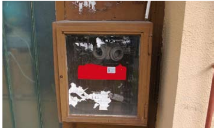
1. kép. A csatlakozó kapcsok, és a zárószelvények is hiányoznak a betáplálási helyen.
