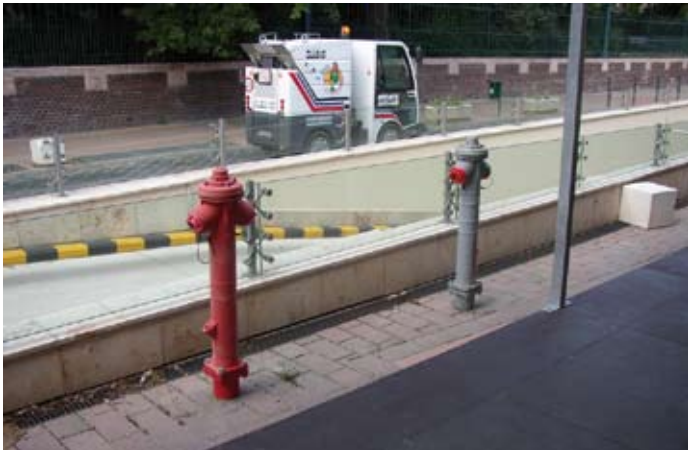
10. kép. Eltérő színben jelölve a tűzcsap és a száraz leszálló vezeték
