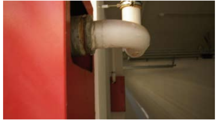
3.b kép. Egy középmagas épület nyitott földszinti garázsában a betáplálási helytől 1,5 méterre került kivitelezésre az első szerelvénytárcsák
