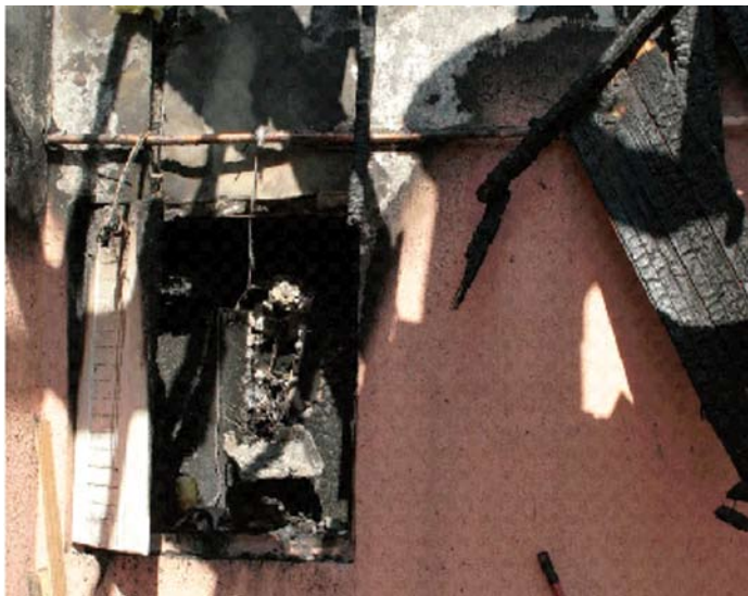
4 sz. kép. Villanyóra szekrényből kiinduló homlokzattűz (forrás: www.langlovagok.hu)
