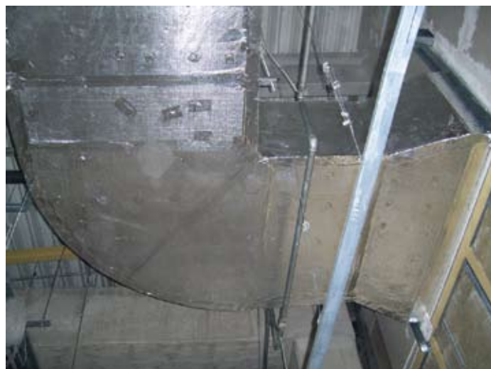
Tűzszakaszon átvezetett csatorna
