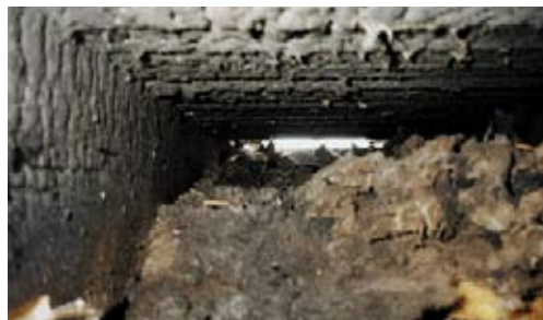
12 sz. kép. Tűzterjedés fa fedélszerkezet légrésében, az üveggapot hőszigetelés ellenére
