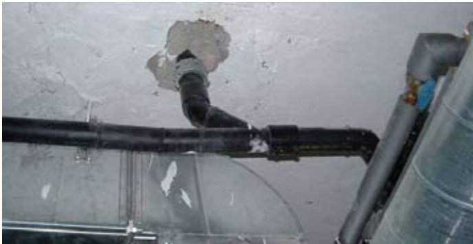
5 sz. kép. Tűzvédelmi mandzsetta a földem helyett a csatorna-vezetékre rögzítve – így a csatorna-vezetékkel együtt szakad le, illetve sérül tűz esetén
