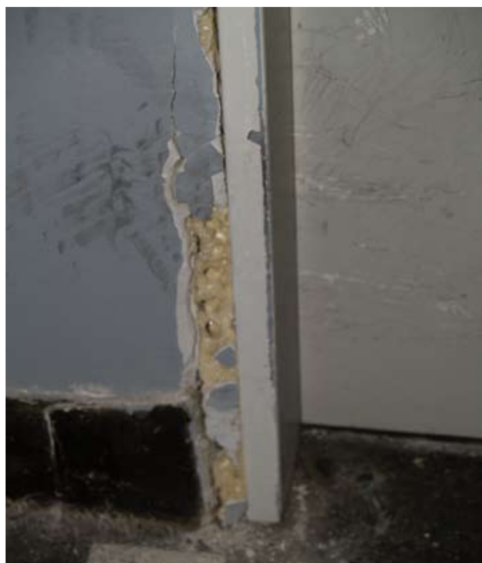
2 sz. kép. Tűzgátló ajtó szakszerűtlen beépítése – napjainkban a tűzgátló ajtók többségét is poliuretán habbal rögzítik vagy tömítik amely még az ajtók nagy tömegéből adódó igénybevételeket sem bírja
