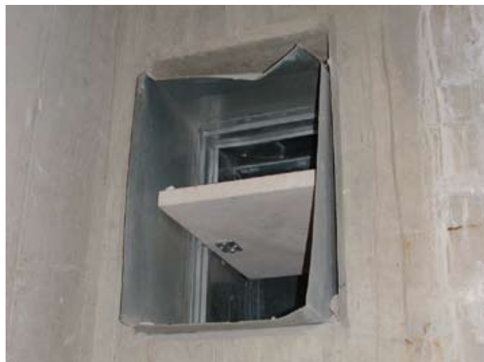
1 sz. kép. Tűzcsappantyú gépészeti aknacsatlakozása kibontást követően. A mechanikai sérülést egy, az aknába az építés alatt bejuttatott zsalukó okozta, amely az aknán kívül nem látható
