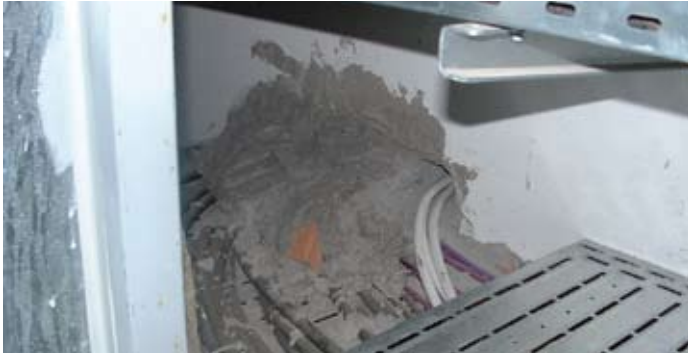
4 sz. kép. Tűzgátló tömítőhabarcs egy A kategóriás irodaházban. Nemcsak a szennyezés indokolatlan mértékű, de a gyakori átalakítások miatti helyreállítás is körülményes, vagy egyszerűen nem történik meg
