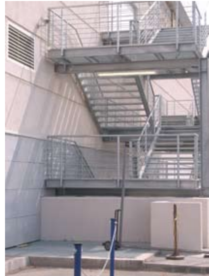
6 sz. kép. Használati, kiviteli hiányosságok – Pince szintű hő- és füstelvezetés vízszintes vasrácsos kivezetése közvetlen a lépcső mellett helyezkedik el
