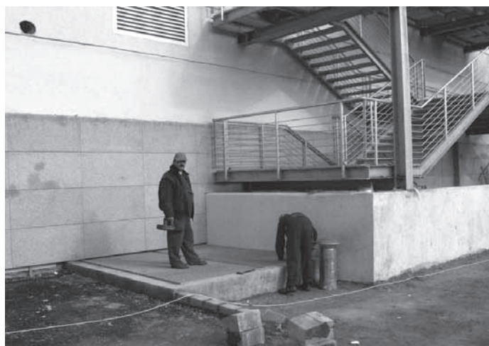
Az álló ember a pincei füstelvezetés kivezető-nyílásán áll, ennek közvetlen közelében - a kollégájától jobbra - sikerült elhelyezni a pincei tűzgátló előtér légbeszívó nyílását
