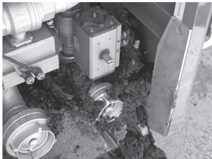
A szivattyútéri fellépő összegyűjti a sarat
