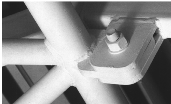
Tűzvédő bevonattal kezelt acél tartószerkezet
