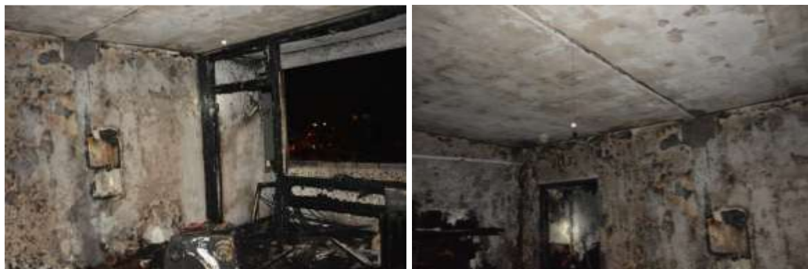
2. ábra: Panel lakóépület IX. emeleti lakásában keletkezett tűz helyszíne, 2020
