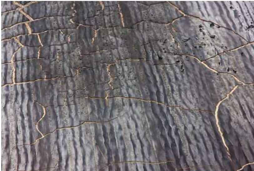
– QuadCore kormozódás és felületi repedések
