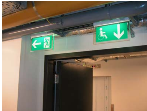
5. ábra: Menekülési útvonal, illetve a mozgássérültek átmeneti tartózkodását biztosító tűzgátló előtér jelölése irányfény-lámpatestekkel (Four Seasons Hotel Gresham Palace)
