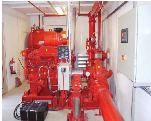
9. ábra: Habsprinkler gépház
